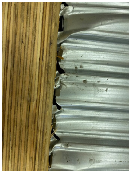
Рис. 9.16. Смятие стенки в опорном сечении
